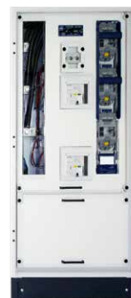
■ Verteiler mit NA-Abschaltung
