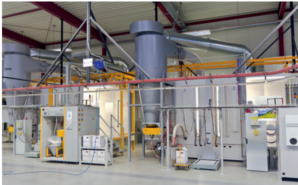
Einfarben- und Mehrfarbenlinie stehen direkt hintereinander: Das nachträglich installierte zweite Einfarben-Kabinensystem ist in Linie direkt vor der bestehenden Anlage platziert. Quelle (drei Fotos): Gema
